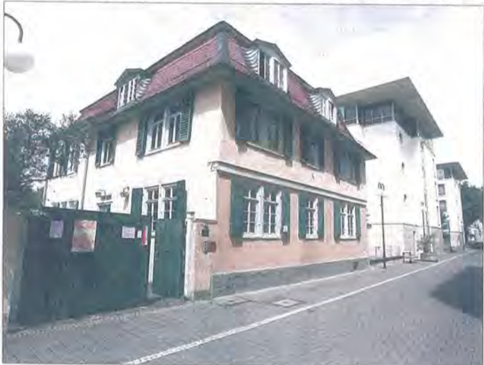
Gravierende Schäden wurden an der Fachwerk-Konstruktion des Pfarrhauses der Französisch-Reformierten Gemeinde in der Herrnstraße 55 festgestellt. Foto: Georg
