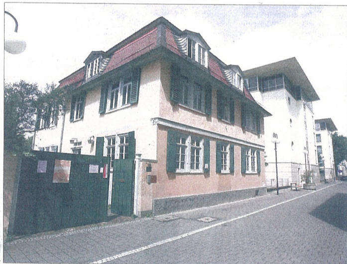
Gravierende Schäden wurden an der Fachwerkkonstruktion des Pfarrhauses der Französisch-Reformierten Gemeinde in der Herrnstraße 55 festgestellt. Foto: Georg
